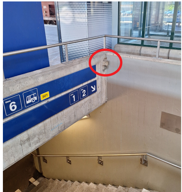
Stromanschluss 230V 13A
