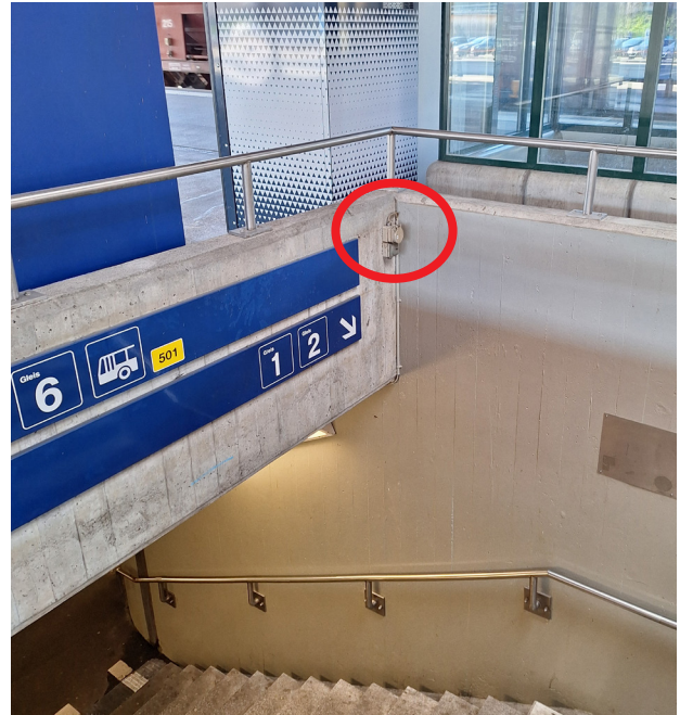
Branchement électrique 230V 13A
